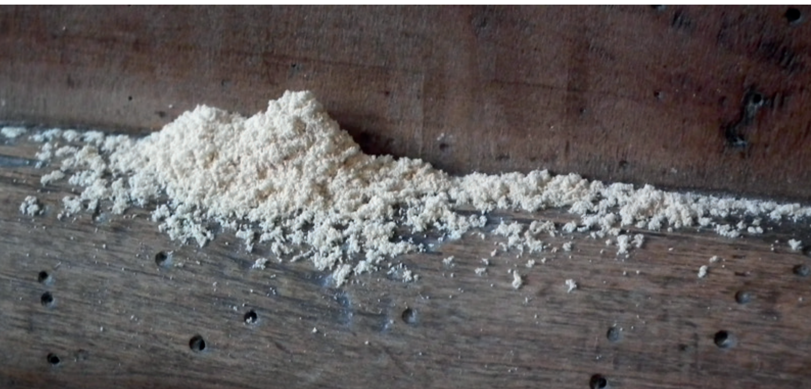
Abb. 3: Substanzverlust durch Schädlingsbefall – das häufigste Problem in allen Kirchenburgen.
