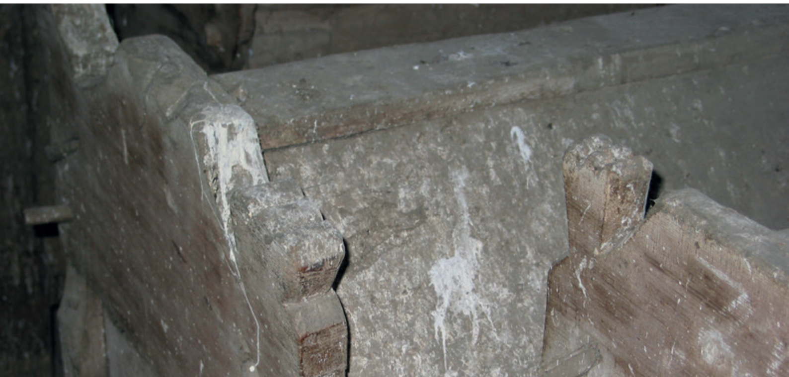
Abb. 2: Verunreinigung der Oberfläche durch Taubenkot.
