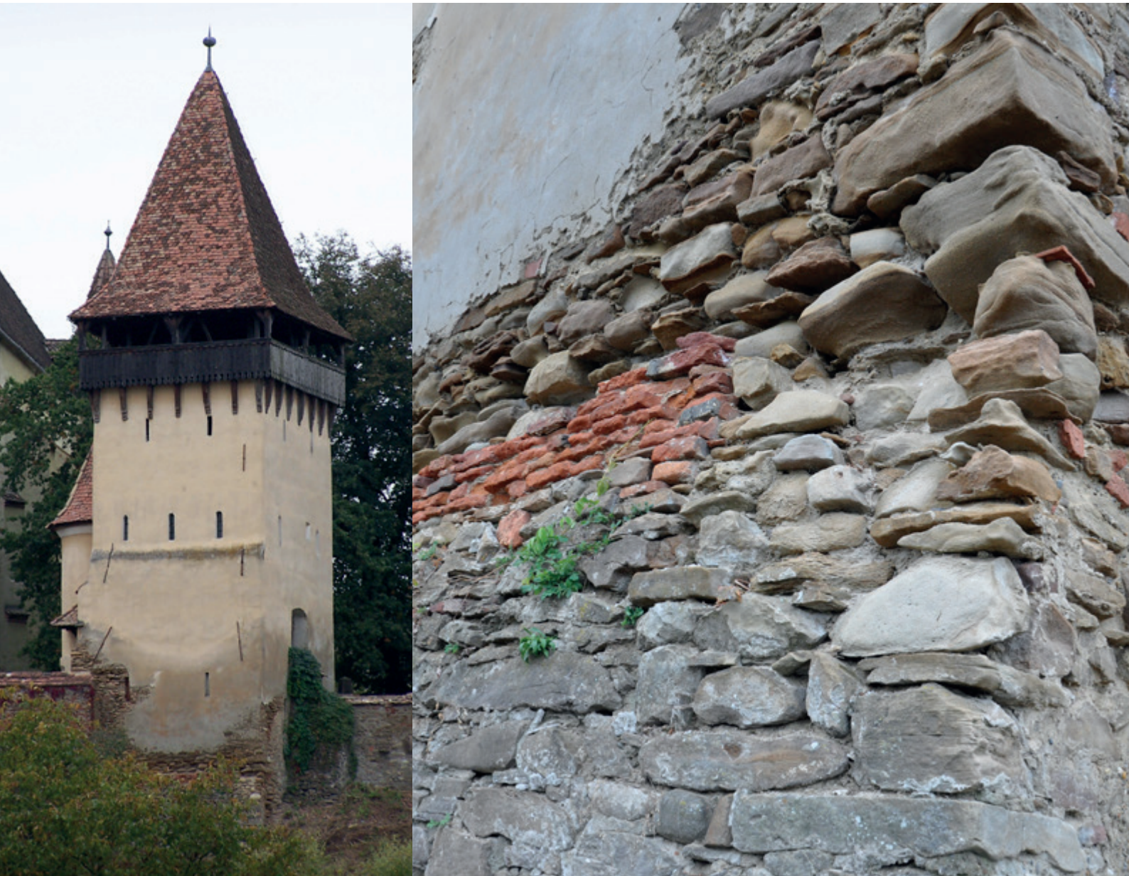
Abb. 6: Mausoleumsturm Ansicht Ost – Nord, mit Feuchteschäden
